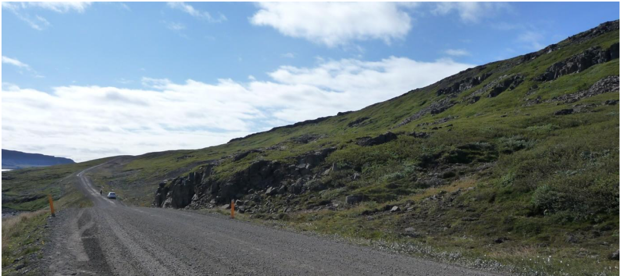
Mynd 26. Horft úr stöð 3400-3450 út vestanverðan Mjóafjörð. Á þessu svæði eru áætlaðar miklar skeringar sem munu ná 40m upp í hlíðina frá núverandi vegi auk þess sem vegurinn verður færður nær fjörinni og 7m niður í núverandi landslag. Skeringin sést á þrívíddarmynd 11.
